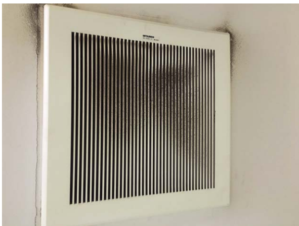
換気扇が汚れています
