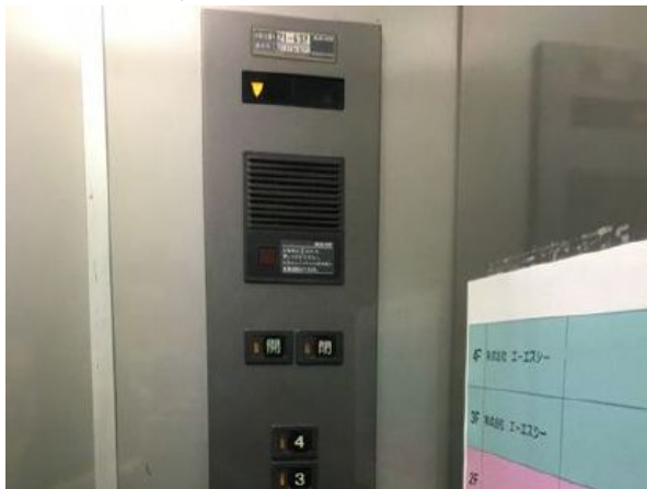
15. エレベーター
